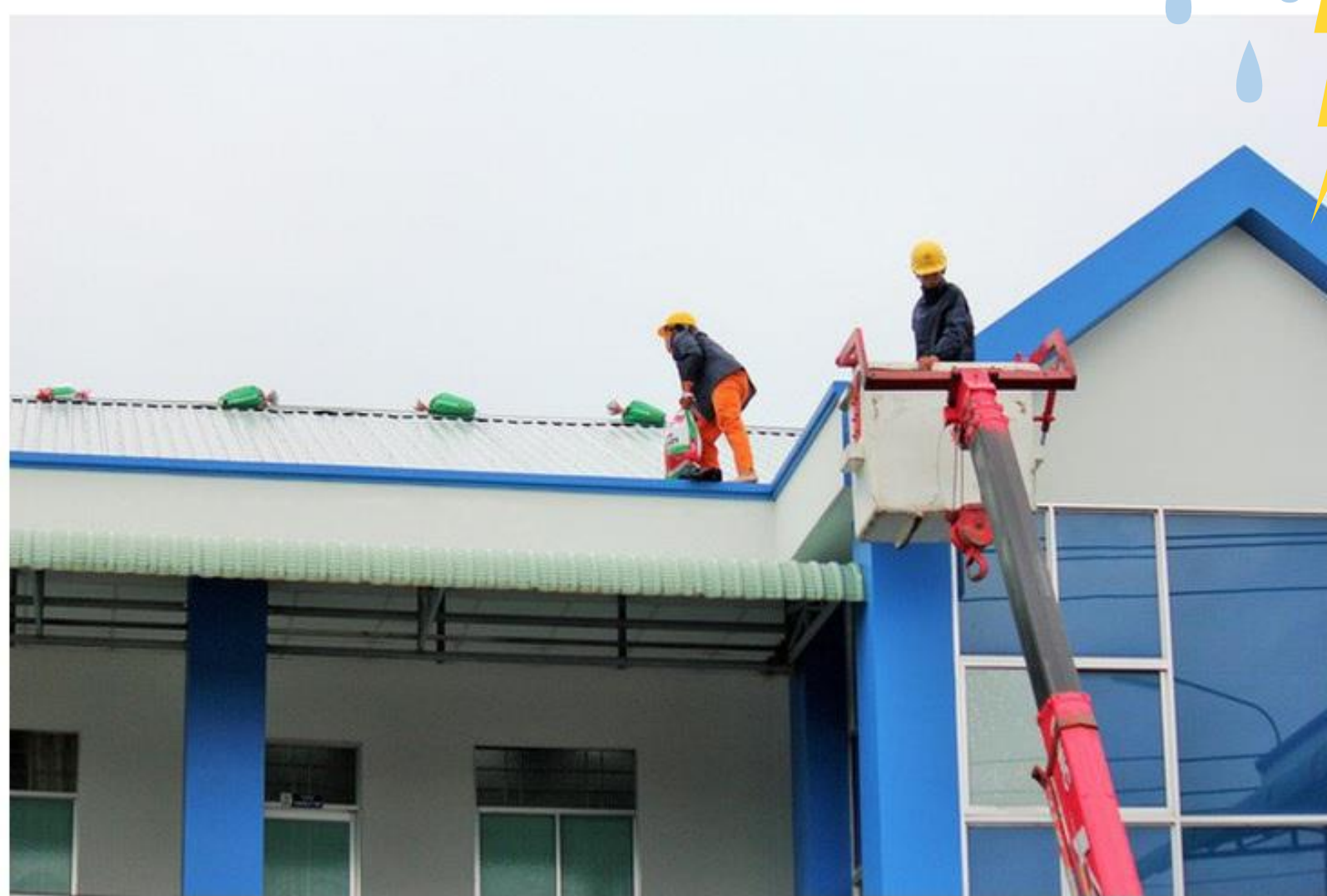
Nhân viên điện lực huyện Bình Đại, tỉnh Bến Tre dùng bao cát để tản mái tôn trụ sở công ty - Ảnh: Mậu Trường
